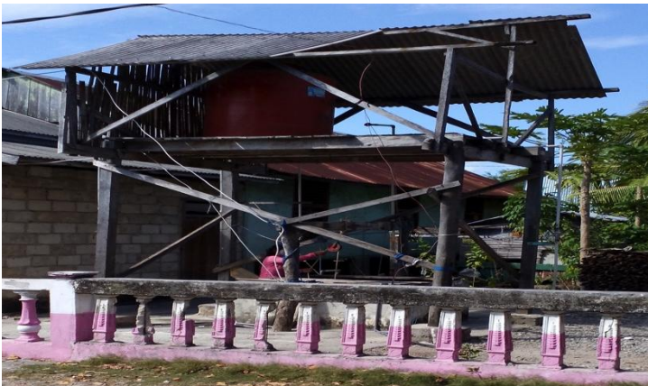
Gambar 2.3-9. Sumur Warga di Desa Lalole dengan Fasilitas Penampungan Air
